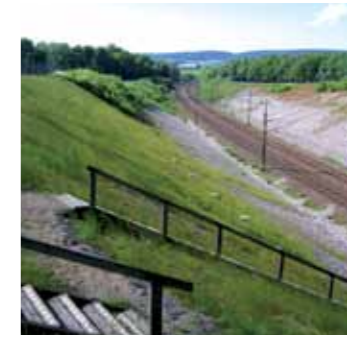
GREENFIX f 3 Covamat (praėjus šešioms savaitėms po instaliavimo)
