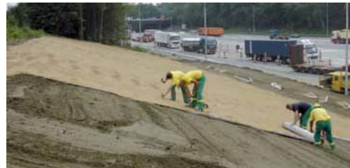
Maždaug 60 000 kv. m Covamat fresh dangos buvo instaliuota Antverpeno (Belgija) kelio žiede
